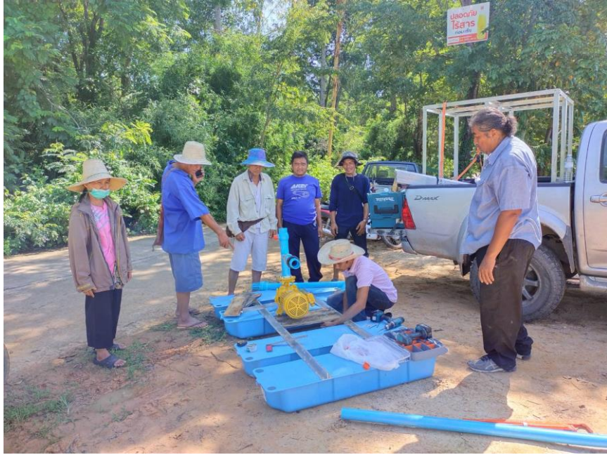
ชุมชนร่วมกันประกอบท่อนลอยน้ำ เพื่อใช้ในการติดตั้งฐานแผงโซลาเซลล์และเครื่องสูบน้ำ
