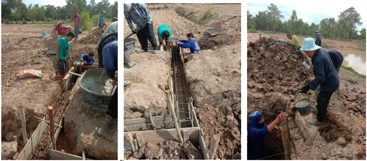
ชุมชนร่วมกันติดตั้งแบบ ผูกมัดมัดเหล็ก และเทปูนประกอบฐานอาคาร
