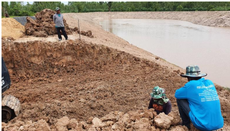
ชุมชนจ้ างเหมารถแบ็คโฮขุดคันดินเพื่อเตรียมวางท่อ คสล. ขนาด 0.80 เมตร และช่วยกันปรับพื้นที่ดินให้มีความสม่ำเสมอ
